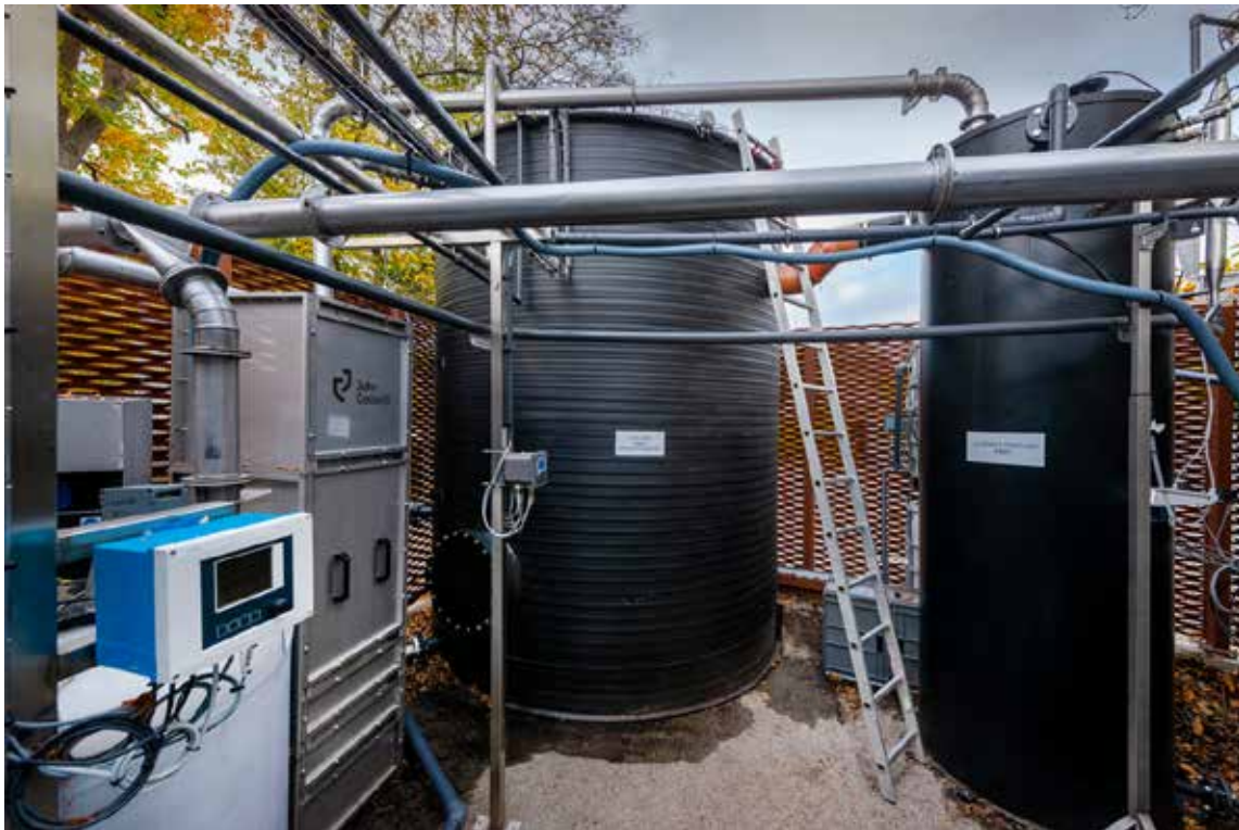
FIGURE 3. CUVES DE TRAITEMENT DE L'INSTALLATION PILOTE MEDIX
